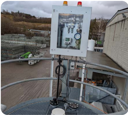
Steuerung auf dem Behälter Control installed on the tank
