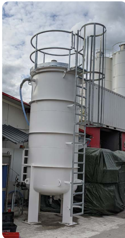
Schlaufenreaktor SR 5 Loop reactor SR 5
