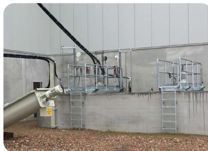
Betonbecken mit Rührwerken Concrete basin with agitators
