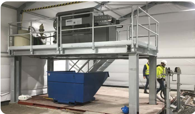
AF 630 auf Bedienungsbühne AF 630 on a service platform
