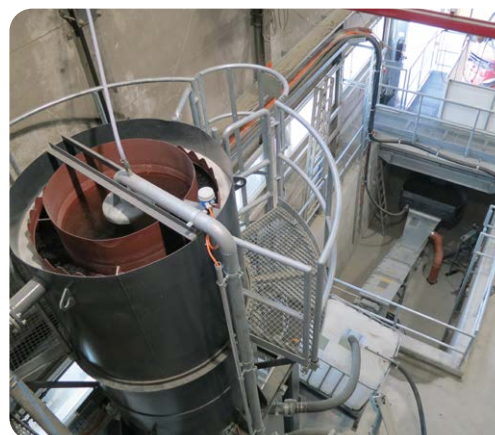
Versenkte Auswaschschnecke mit Klärturm Washout screw with sedimentation tower
