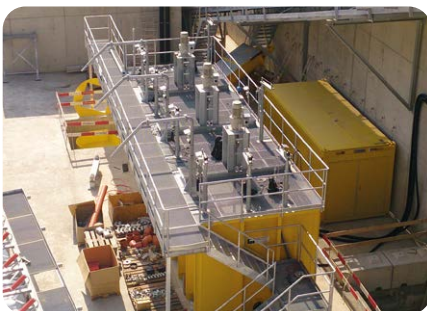
Rührwerksbehälter mit Bedienungsbühnen Agitation pool with service platform
