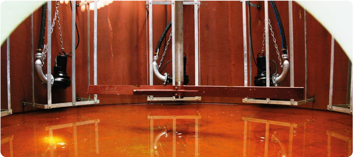
Rührwerk mit Tauchmotorpumpen in Schutzkörben Agitator with submersible pumps in protective cages
